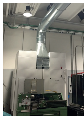
► Composée de deux « Pascal 9000 Losma », l'installation traite l'ensemble des fumées et des micro-brouillards arrivant du réseau de captage
